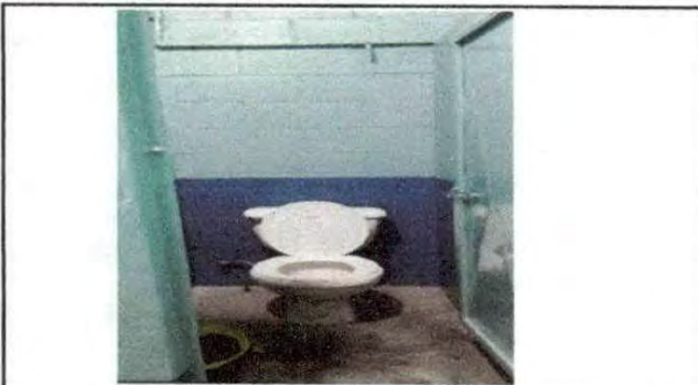
Foto 3: SERVICIOS SANITARIOS Y SUS ACCESORIOS
